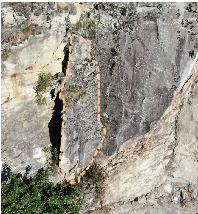
Immagine 1: Il 23 aprile 2024 è stato rimosso il primo blocco di roccia presso il raccordo di Buseno.
